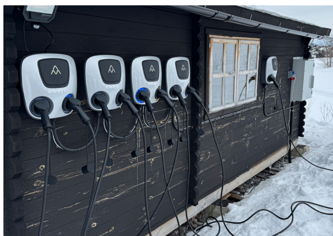
Det har monterat 10 laddplatser.
