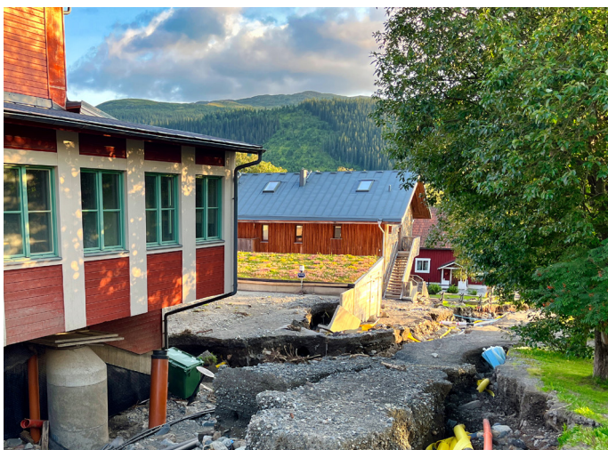
Skador på byggnaden i korsningen Årevägen/Bäckvägen.
